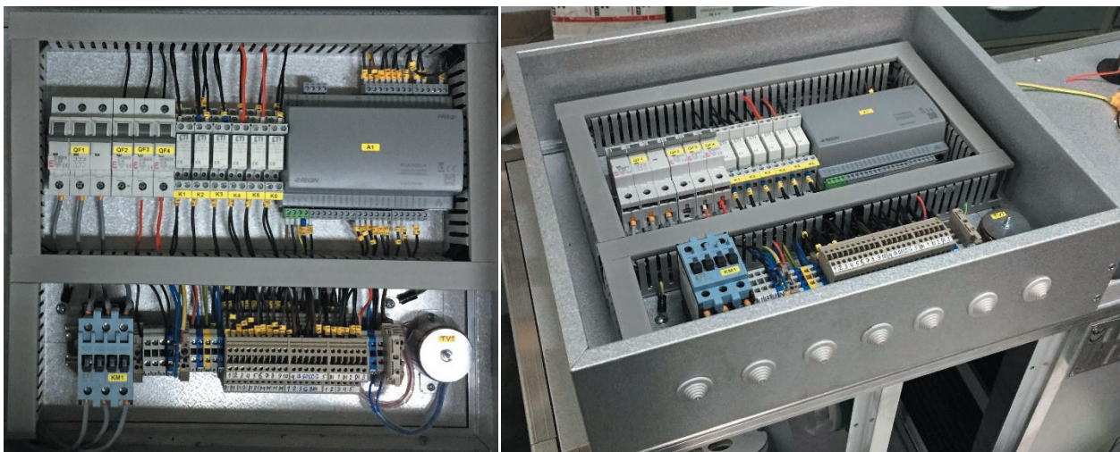
Малюнок 1. Вбудований щит керування на повітрооброблюючій установці.
