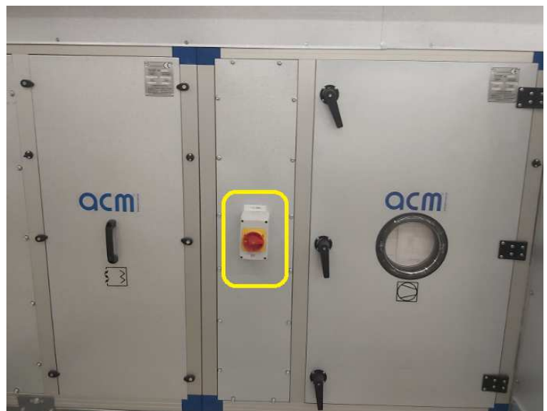
Мал.33. Вентиляційні агрегати.
